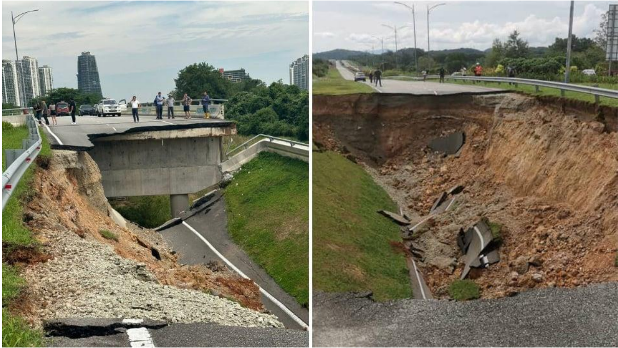
Kejadian tanah mendap sepanjang 25 meter di Jalan Forest City-Lebuh Tanjung Pelepas di Iskandar Puteri. - Foto Bomba
