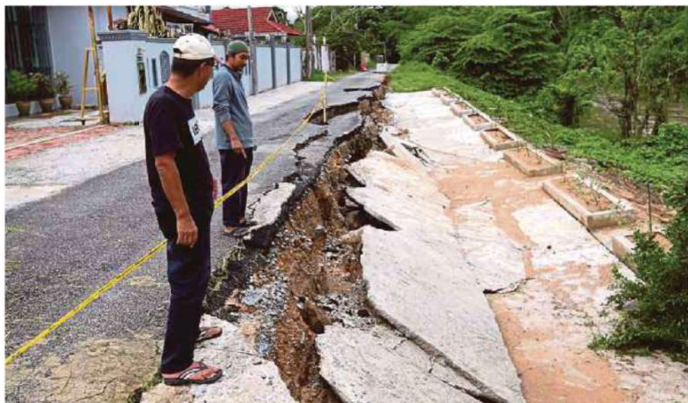
PENDUDUK Taman Baiduri, Kampung Kubang Keranji menunjukkan mendapan tanah yang terjadi akibat hujan lebat apabila ia menjadi laluan air ke Sungai Pengkalan Datu.
